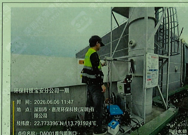
DA001 废气排放监测口
