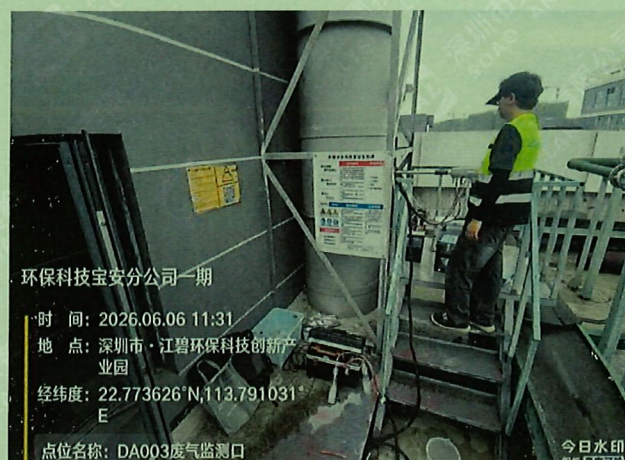
DA003 废气排放监测口
