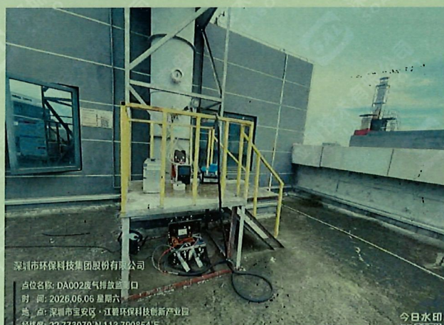
DA002 废气排放监测口
