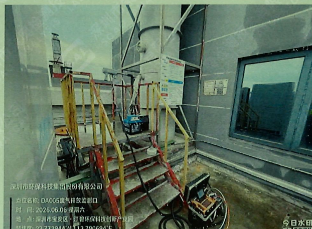
DA005 废气排放监测口
