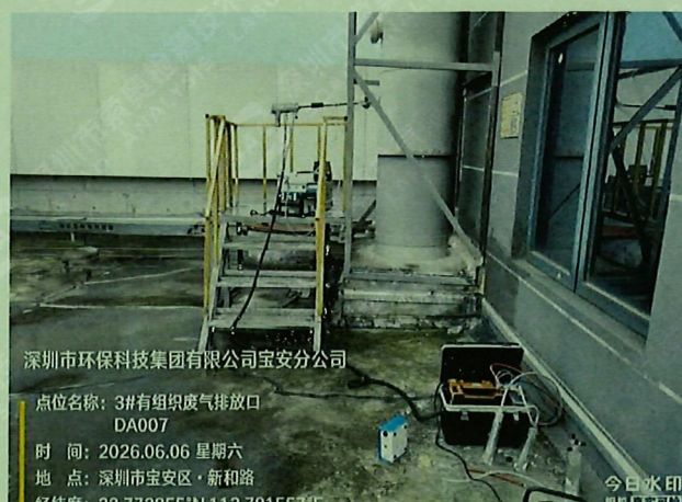
DA007 废气排放监测口
